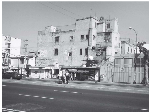
Derogación de equipamiento e infraestructura en la Calzada México-Tacuba de la Ciudad de México.
