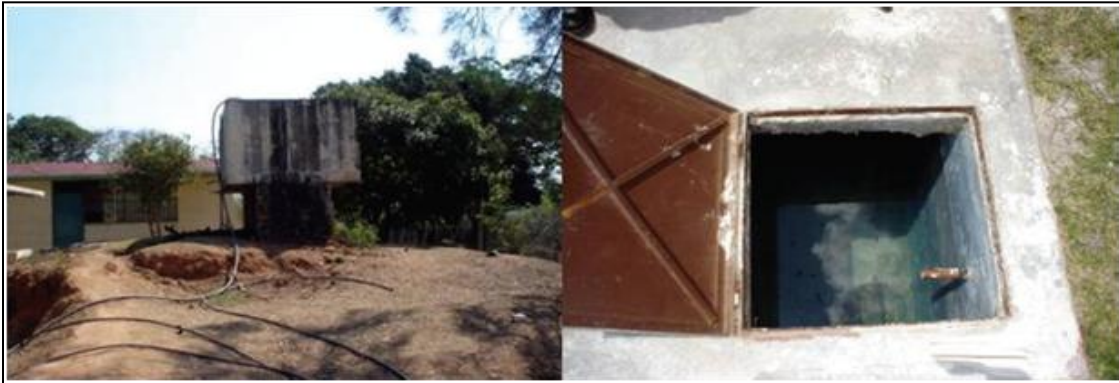
Figura 4.20 Tanque de tabique – cemento.
