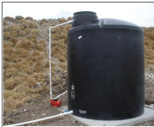
Figura 4.22 Cisterna de polietileno.
