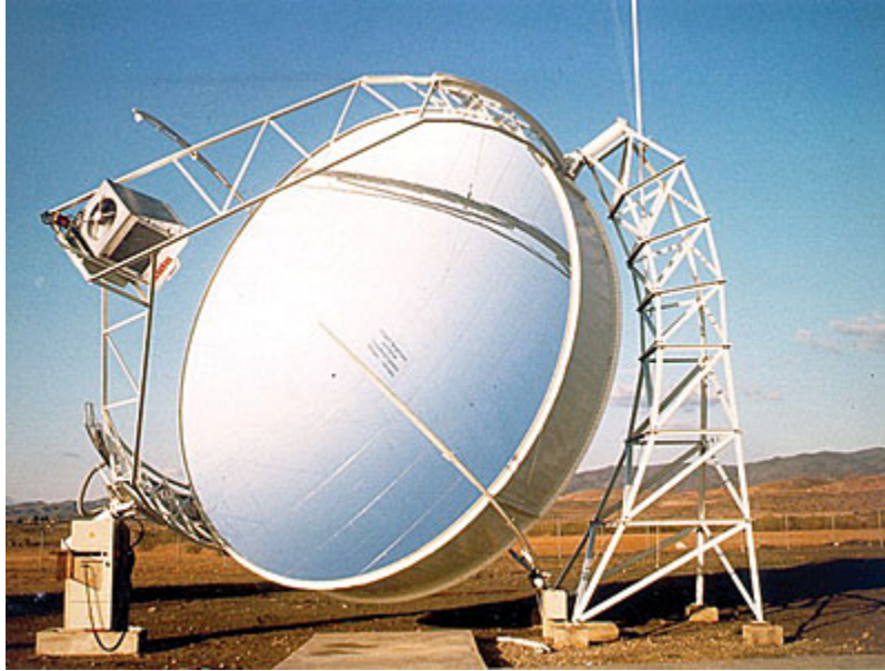
Un sistema DISTAL I en operación en la Plataforma Solar de Almería
