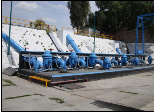
Figura II.4.1 Cárcamos y bombas de agua cruda
