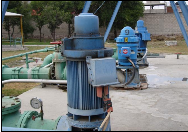
Figura II.5.3 Cárcamos y bombas de agua tratada
