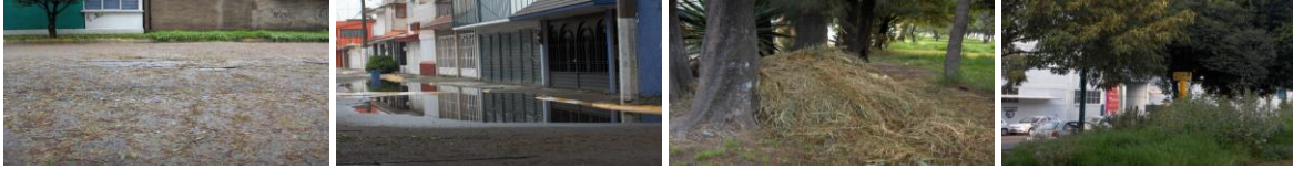
Falta de mantenimiento en el Fraccionamiento Prado Vallejo
