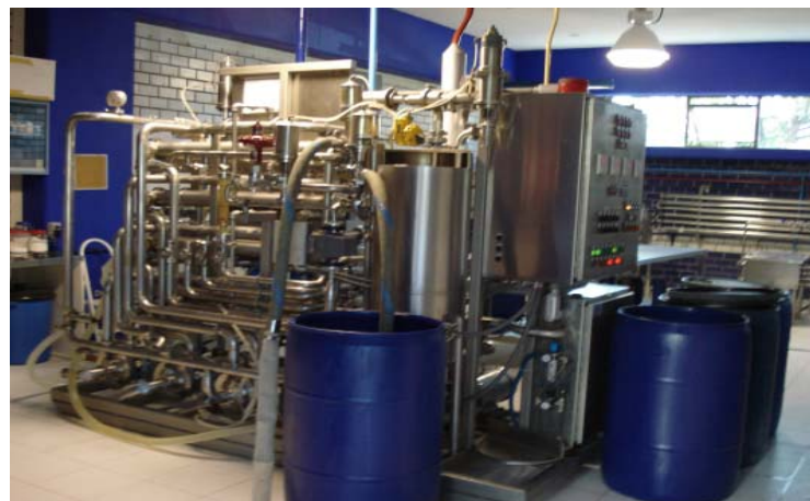
Figura 12. Equipo de Ultrafiltración a nivel planta piloto “Niro”.
