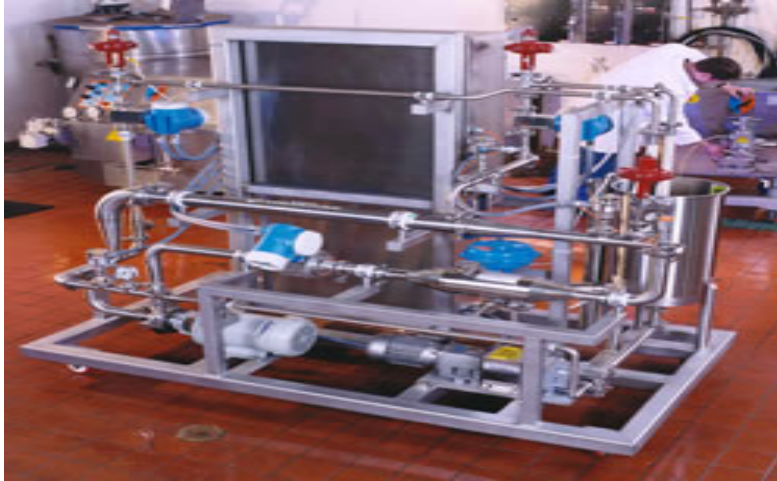
Figura 13. Equipo de Nanofiltración a nivel planta piloto “CETA”.
